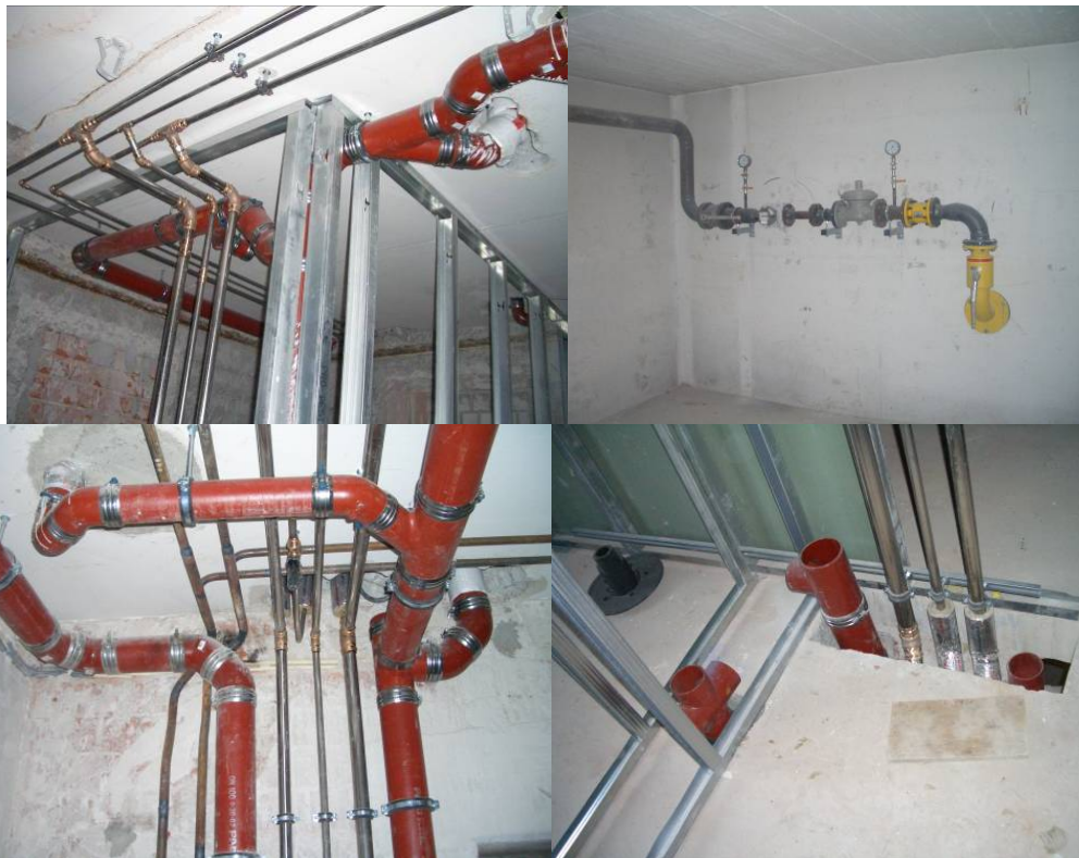
Sanitärinstallation während der Bauphase
